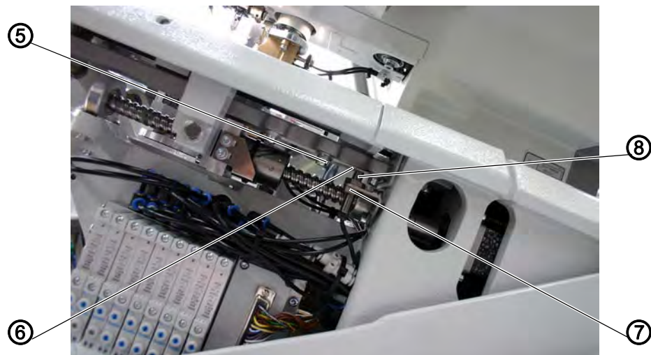
Fig. 21: Опорная платформа для ткани, настройка поперечного перемещения (2)
